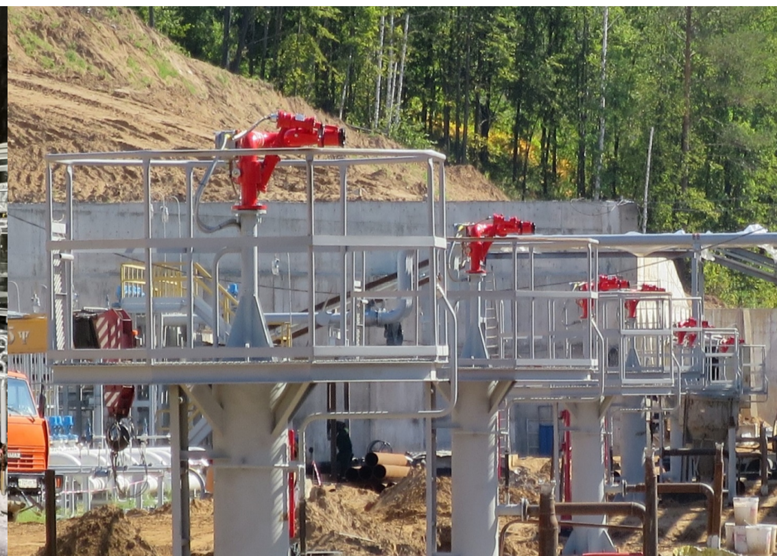
Железнодорожная сливо-наливная эстакада светлых нефтепродуктов и насосная станция пожаротушения
