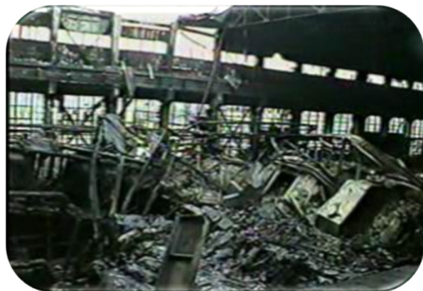
Пожар на Каширской ГРЭС, 2002г.
