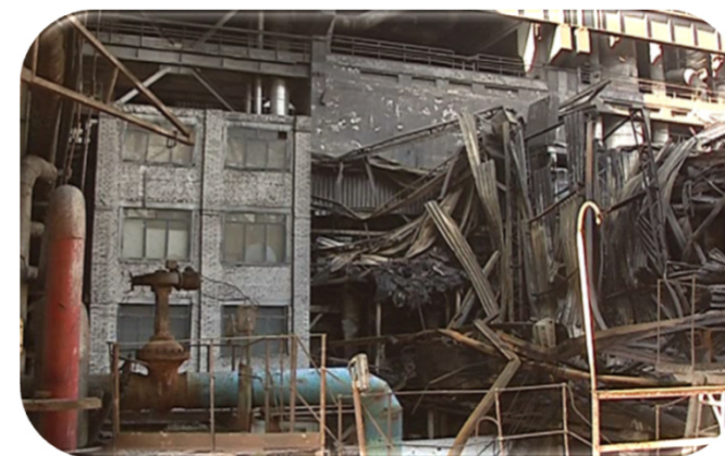
Пожар МЗ Углегорской ТЭС, 2013г.
